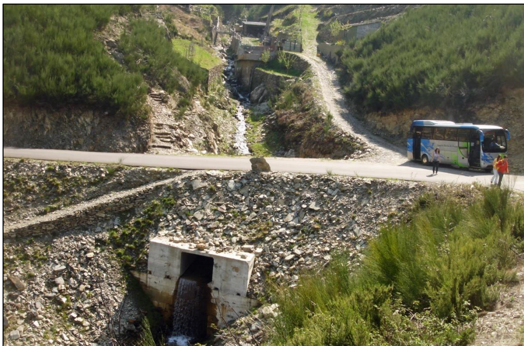
Figura 37. Evolução do corte da estrada de Chãs de Égua após as obras de recuperação tras as precipitações de setembro e outubro de 2006.
