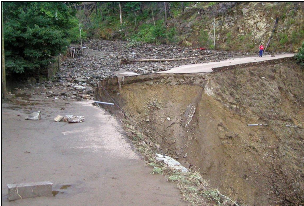
Figura 38. Destruição do parque estacionamento do Piódão, após a inundação provocada pelo episódio pluvioso de 14 de julho de 2006.
