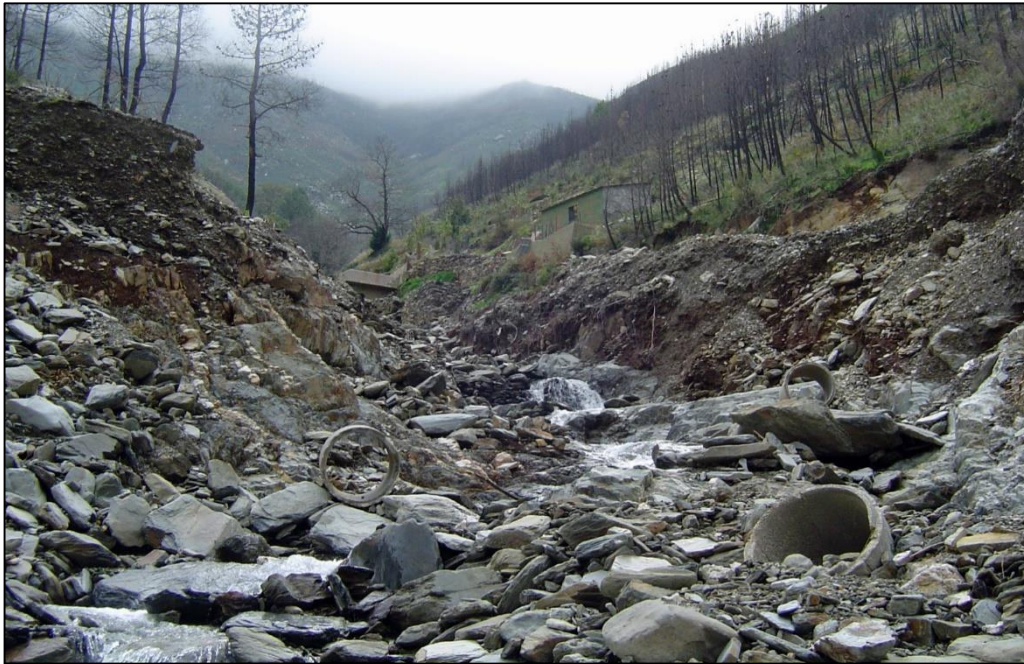
Figura 36. Evolução do corte da estrada de Chãs de Égua, após as precipitações de setembro e outubro de 2006, que levaram à completa destruição da estrada e ao arrastamento da totalidade do material antes depositado, permanecendo algumas manilhas como testemunhas da antiga travessia.
