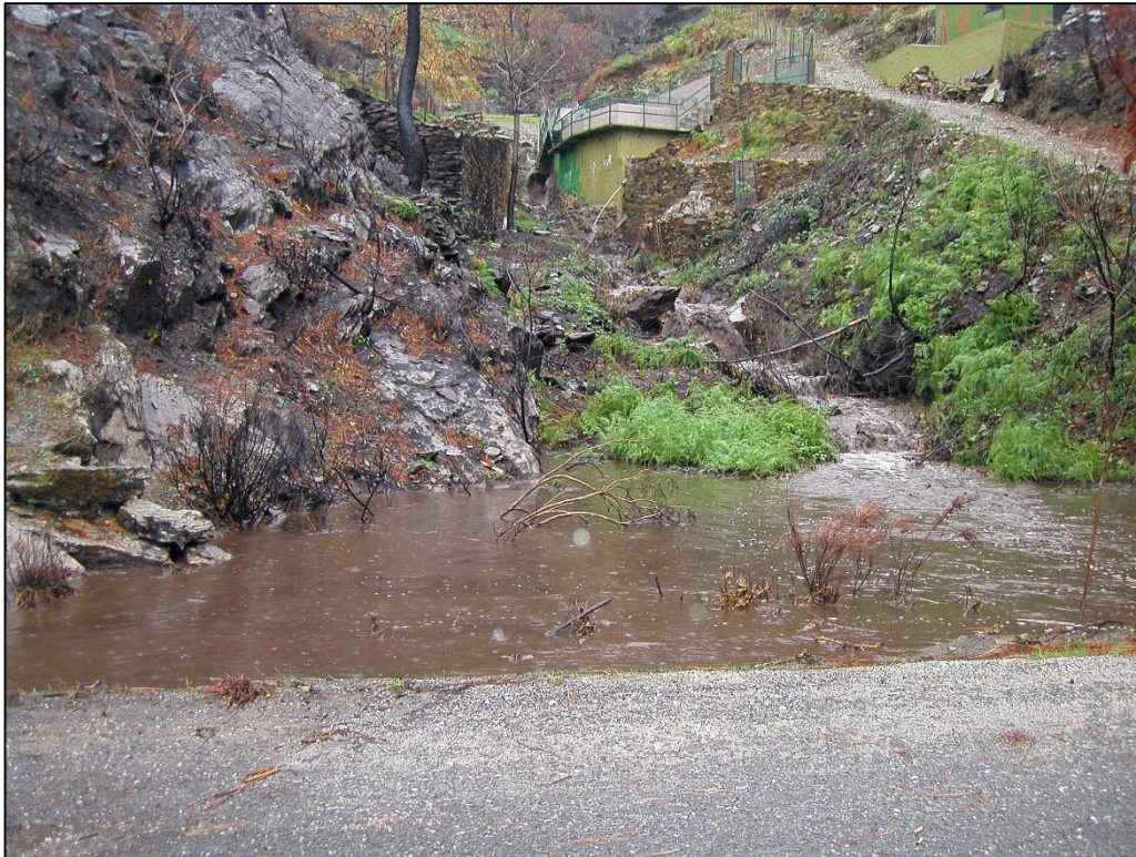
Figura 34. Evolução do corte da estrada de Chãs de Égua. Albufeira de retenção das águas da ribeira do Piódão, por obstrução da entrada das manilhas, na sequência do episódio de 16 de junho de 2006.
